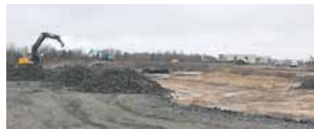
Nivika fastigheter bygger en 10 000 kvm stor logistikfastighet på Bredastensvägen i Värnamo, där 1337 Logistics flyttar in i november i år.
